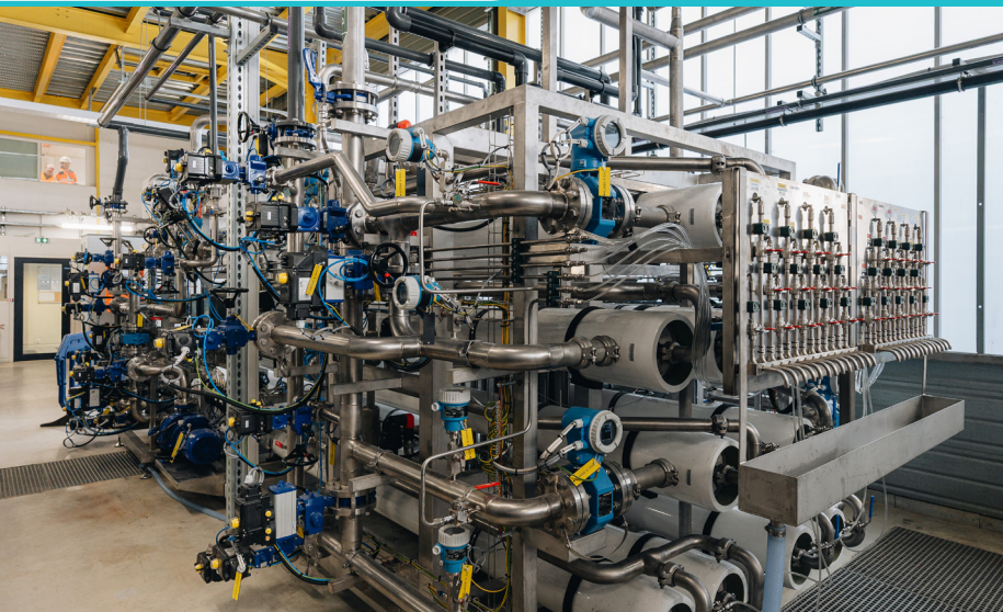
Pilote membranaire haute performance installé en juin 2025 à l'usine de production d'eau potable de Choisy-le-Roi
