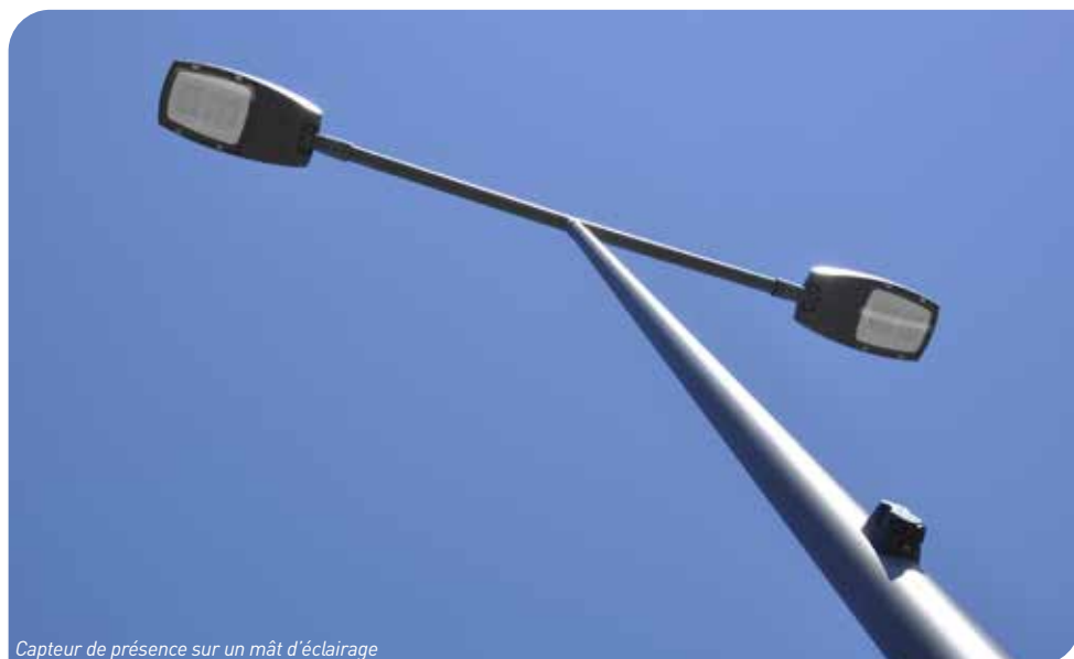
Capteur de présence sur un mât d'éclairage
